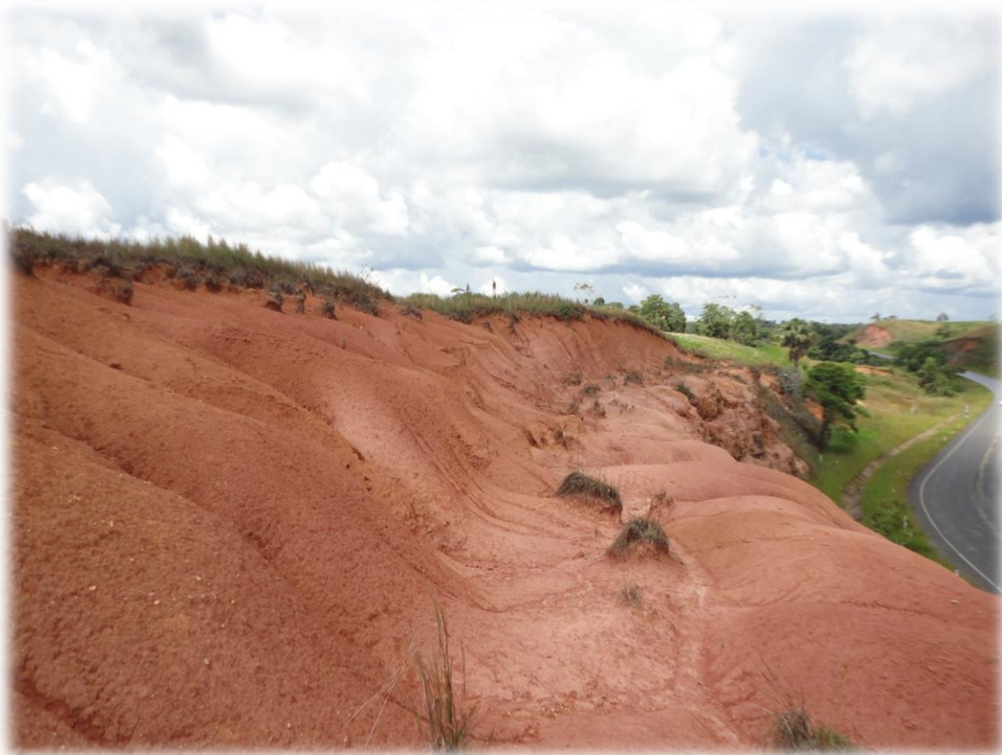
Foto N° 20: Erosión en surcos y cárcavas que afectan capas limo-arcillosas poco coherentes de la formación Nauta, procesos activados por la construcción de la carretera Iquitos-Nauta y la alta pluviosidad de la región. Cerca de la localidad de Nauta, (aproximada UTM: 656,245E/9'502,670N, cota de 123 msnm).
